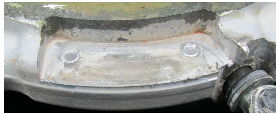
Figura 6: Blocco di sicurezza mancante.
