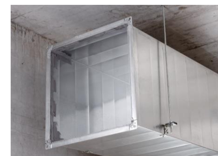
CANALI DI VENTILAZIONE
