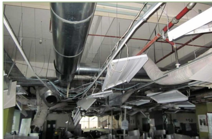
CROLLO DI APPARECCHI DI ILLUMINAZIONE, CANALI FLESSIBILI PER LA DISTRIBUZIONE DELL'ARIA E SVERGOLAMENTO DELLE TUBAZIONI DELLA RETE ANTINCENDIO
