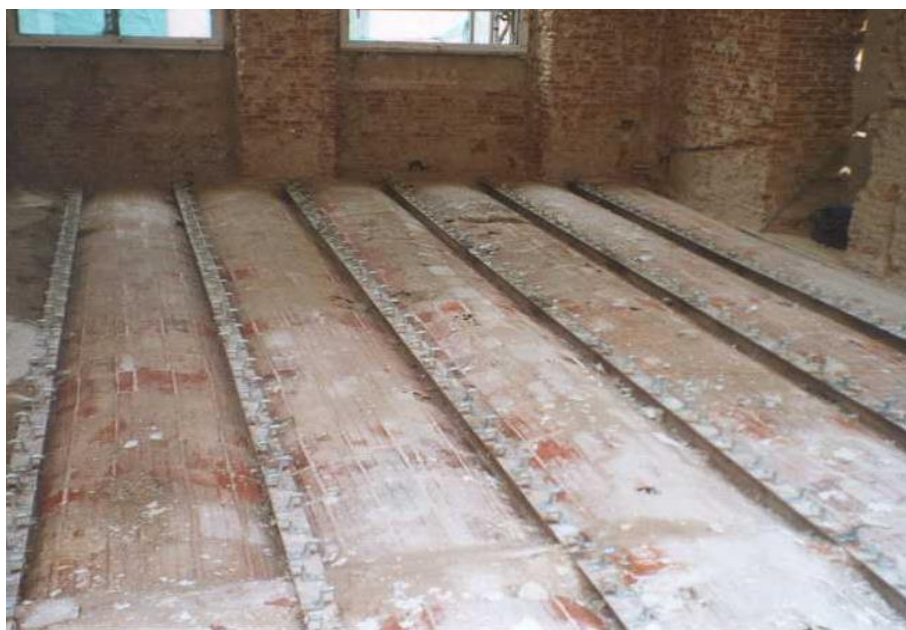
Figura 27 Soletta esistente da rinforzare per mezzo di uno strato sottile di calcestruzzo
